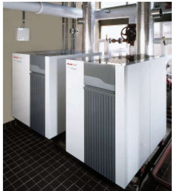
Duo-Anlage modulgas mit Kaskadensteuerung, 1:8 modulierend. Heizleistung 630 kW
